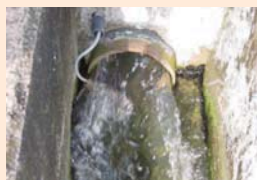
排水溝流量モニタ
