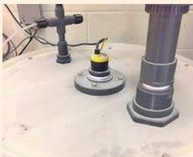
薬品供給タンクのレベル管理
