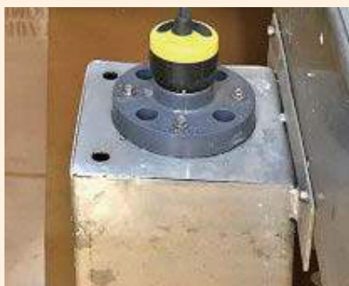
病院冷却塔の液面測定
